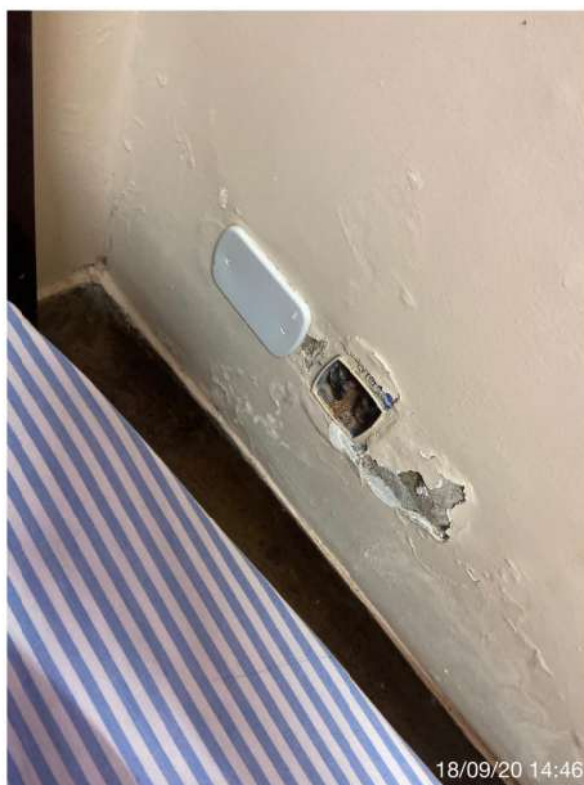
Instalações elétricas precárias
