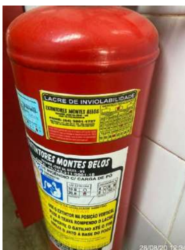
Vista extintor vencido
