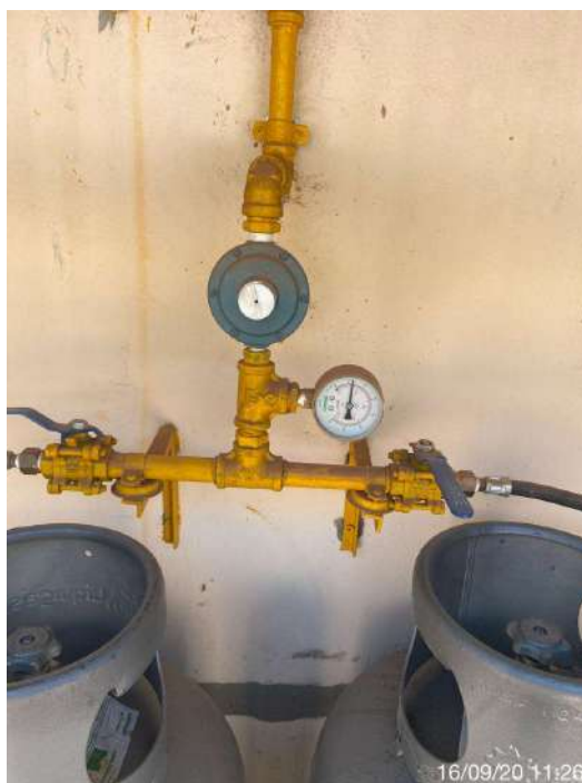
Vista Central de gás GLP
