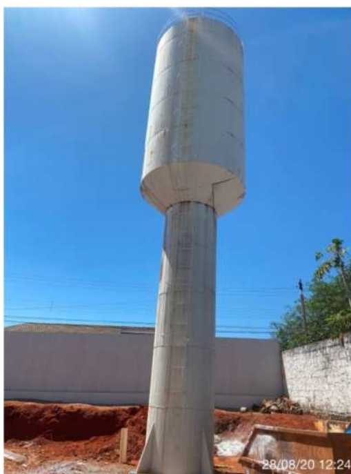
Vista Reservatório metálico tipo taça
