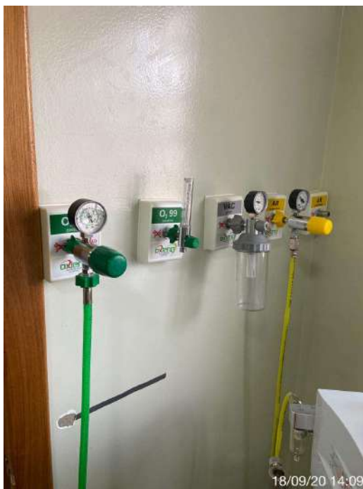
Vista UTI, único local com rede de gases canalizada na unidade
