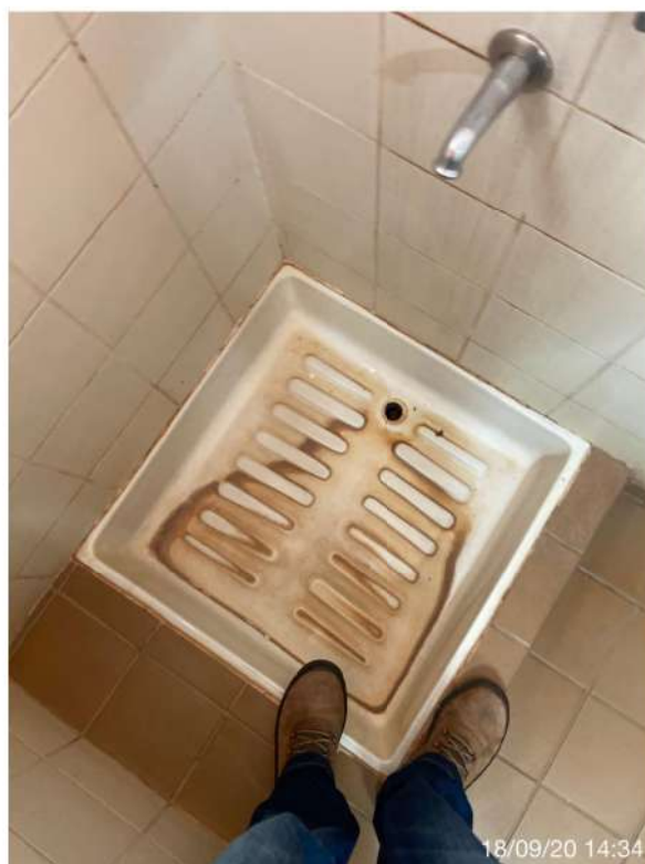
Vista banheiro, local de banho sem acessibilidade
