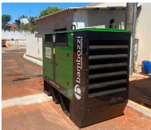
Grupo Gerador locado para alimentar o tomógrafo
