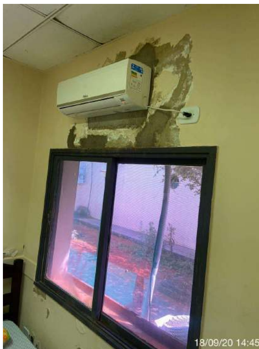
Vista ar condicionado conforto da enfermagem
