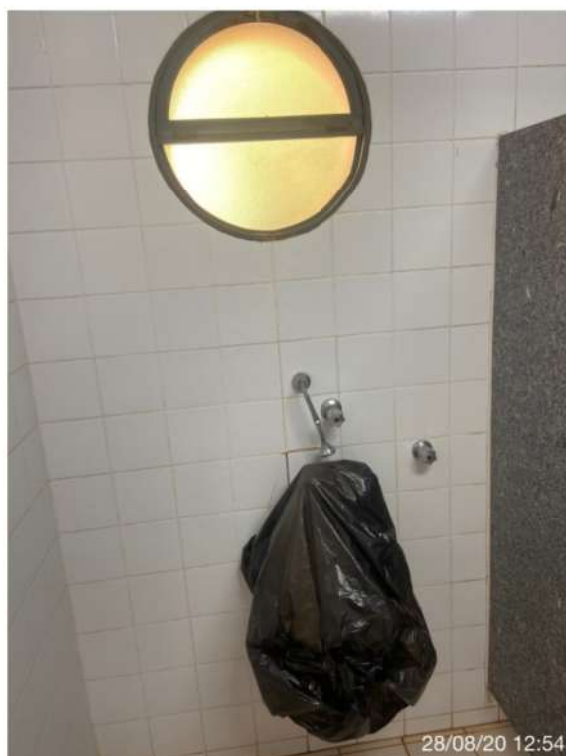
Vista de mictório desativado
