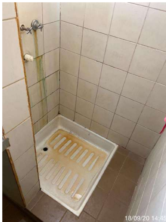
Vista banheiro, local de banho sem acessibilidade
