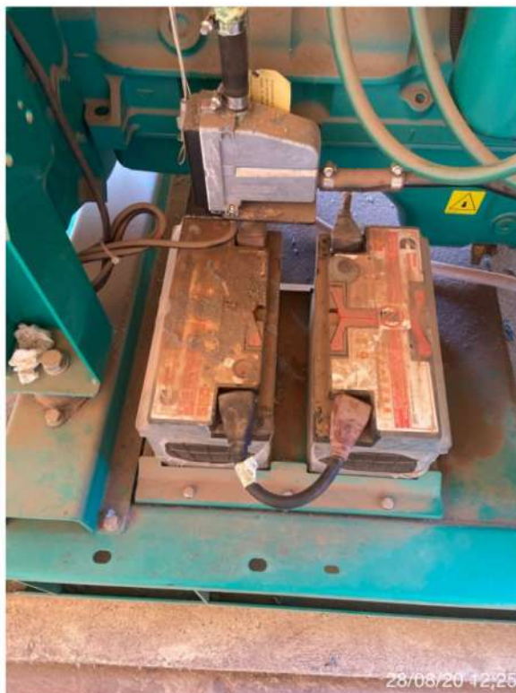
Vista baterias do Gerador
