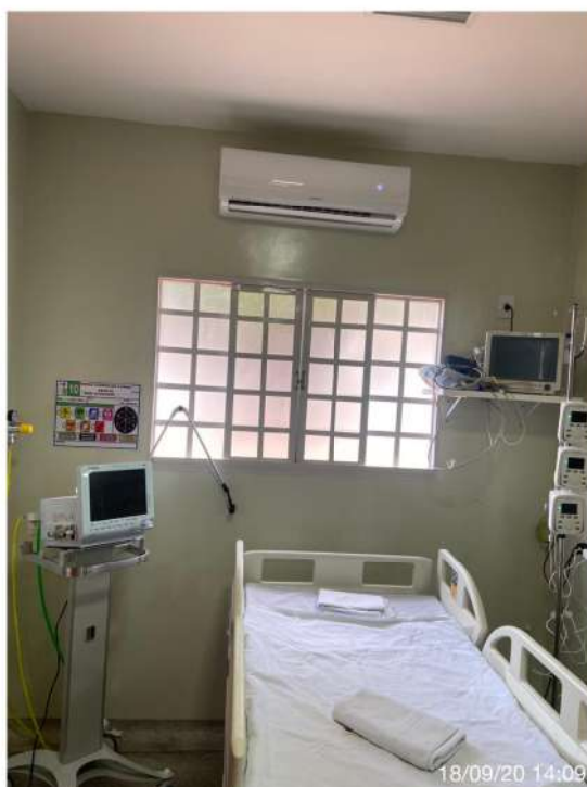
Vista ar condicionado da UTI
