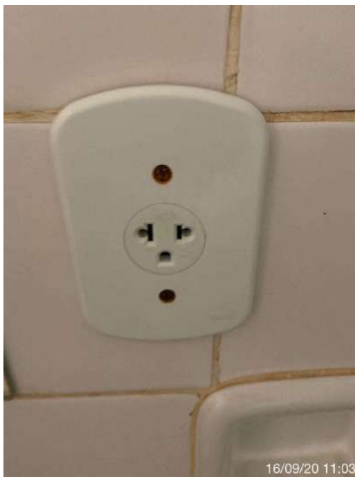
Tomadas em modo geral fora da norma
