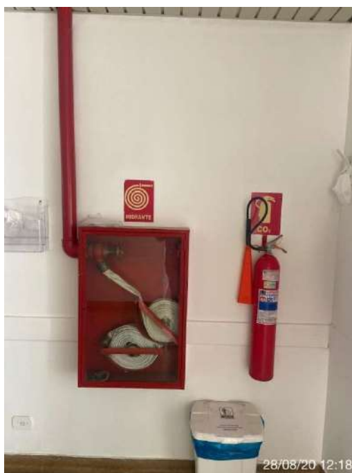
Vista Hidrante e extintor
