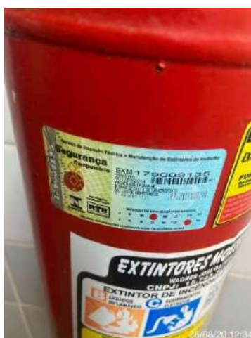
Vista extintor vencido
