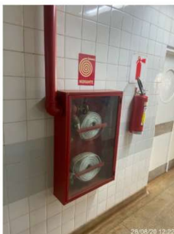
Vista Hidrante e extintor
