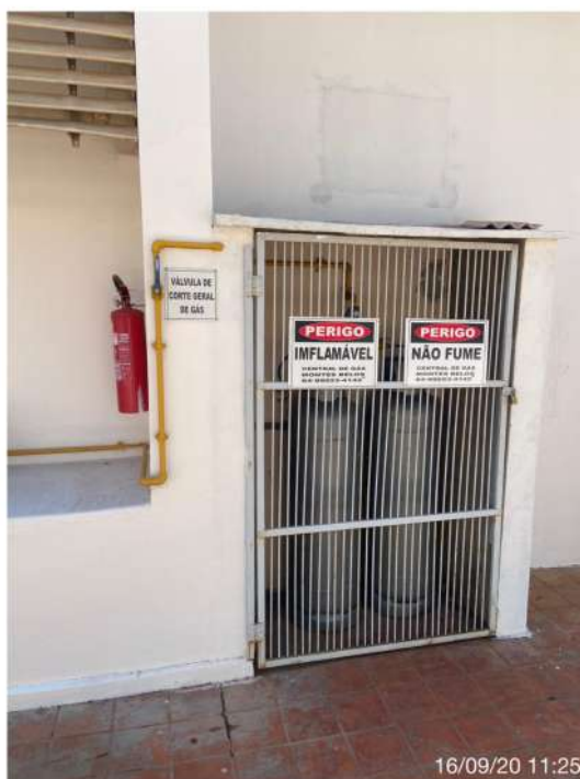
Vista Central de gás GLP
