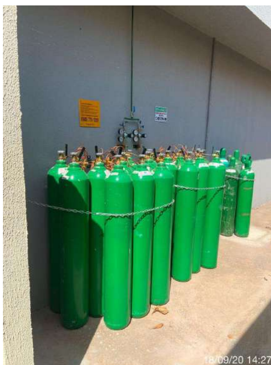
Vista bateria reserva de cilindros de O2 da UTI
