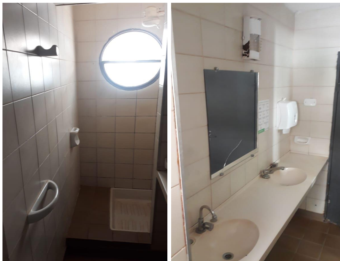
Foto 2. Banheiro da enfermaria.
