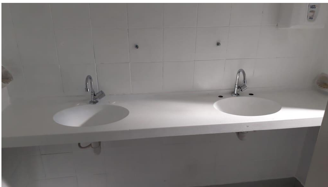
Foto 4. Azulejos pintados e torneira substituída.
