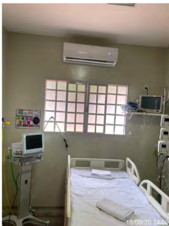
Vista ar condicionado da UTI
