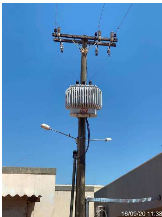
Transformador que alimenta a unidade
