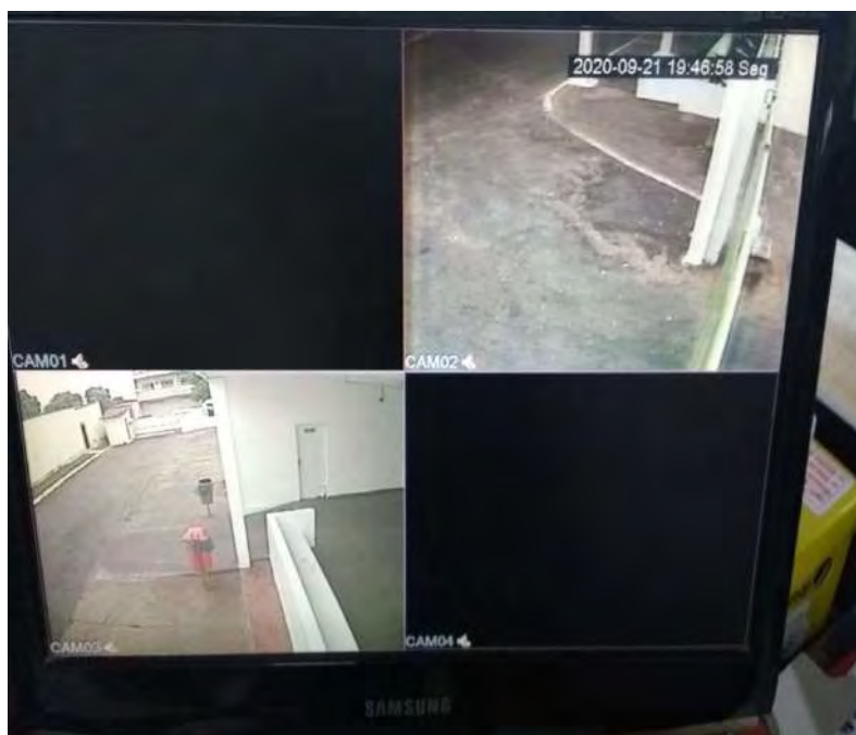
Vista da central de monitoramento, apresentando falhas em algumas
