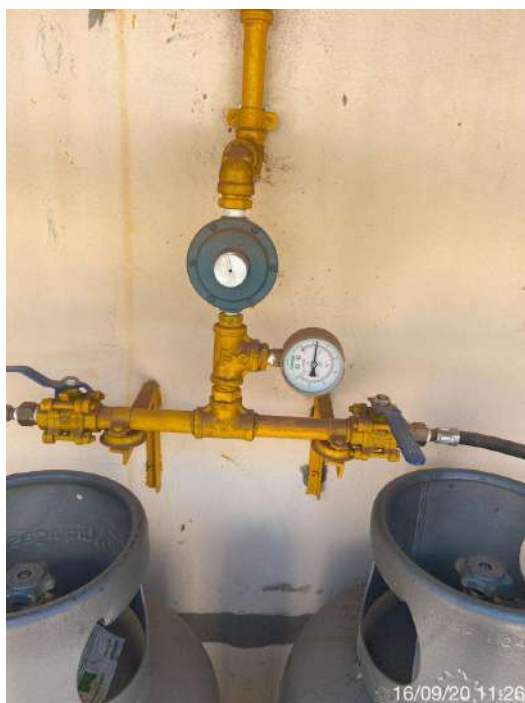
Vista Central de gás GLP
