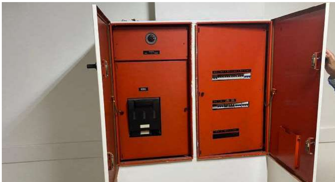
Quadro Geral sem identificação e com disjuntores fora de norma
