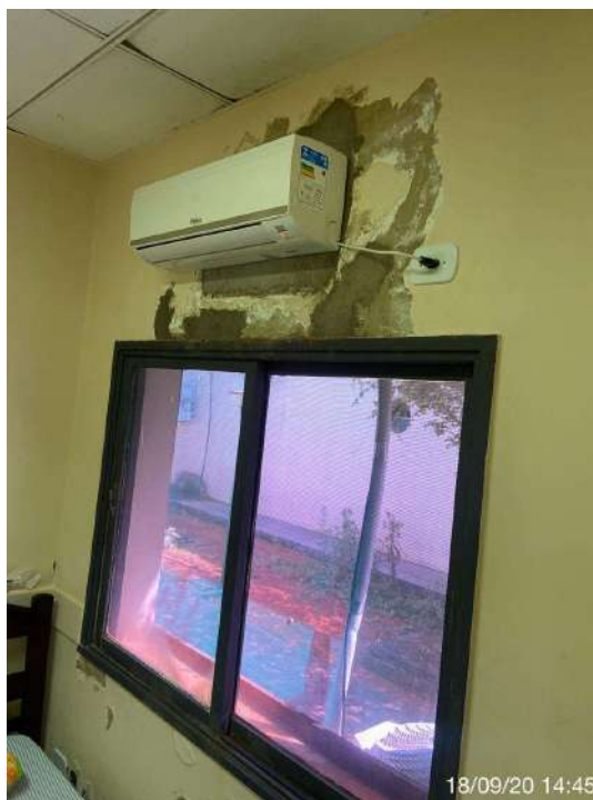
Vista ar condicionado conforto da enfermagem
