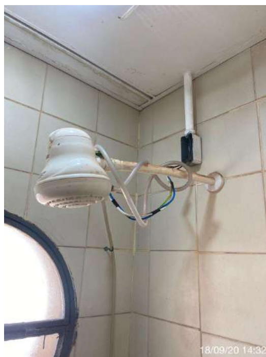
Instalações elétricas precárias
