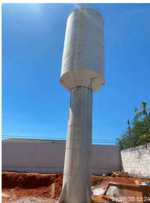
Vista Reservatório metálico tipo taça
