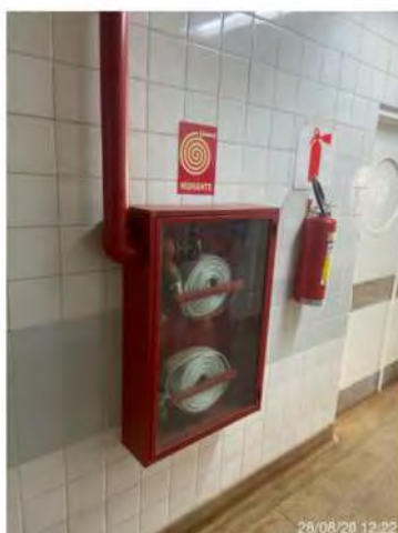
Vista Hidrante e extintor
