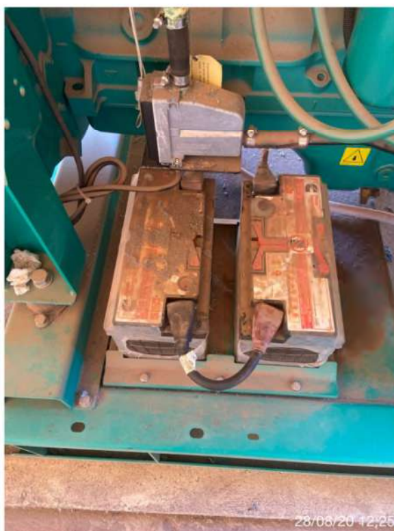
Vista baterias do Gerador
