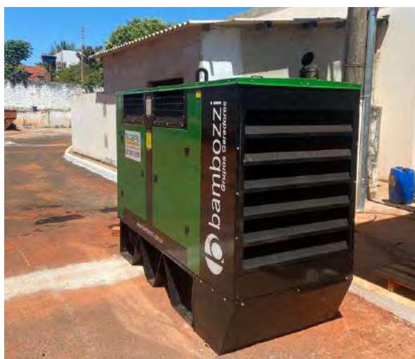
Grupo Gerador locado para alimentar o tomógrafo
