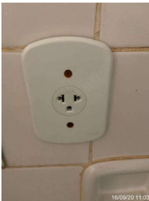
Tomadas em modo geral fora da norma
