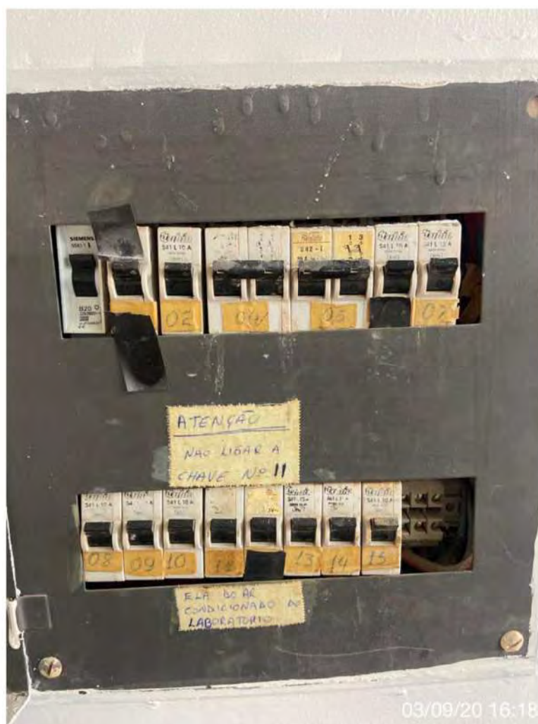
Quadro de distribuição sem identificação e com componentes expostos
