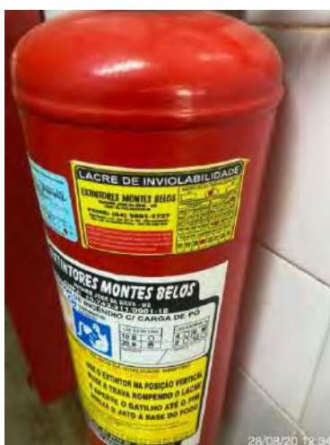
Vista extintor vencido
