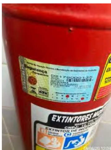
Vista extintor vencido
