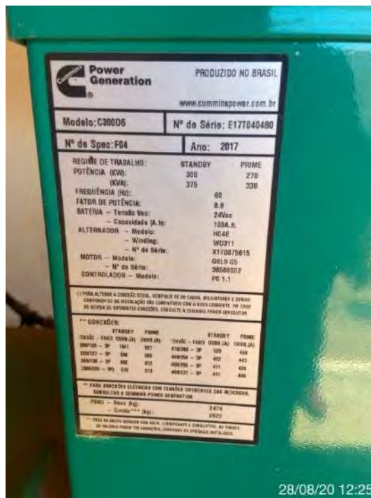
Plaqueta de descrição técnica do Gerador
