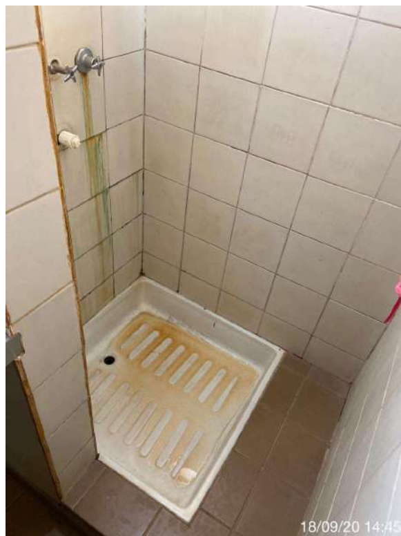
Vista banheiro, local de banho sem acessibilidade
