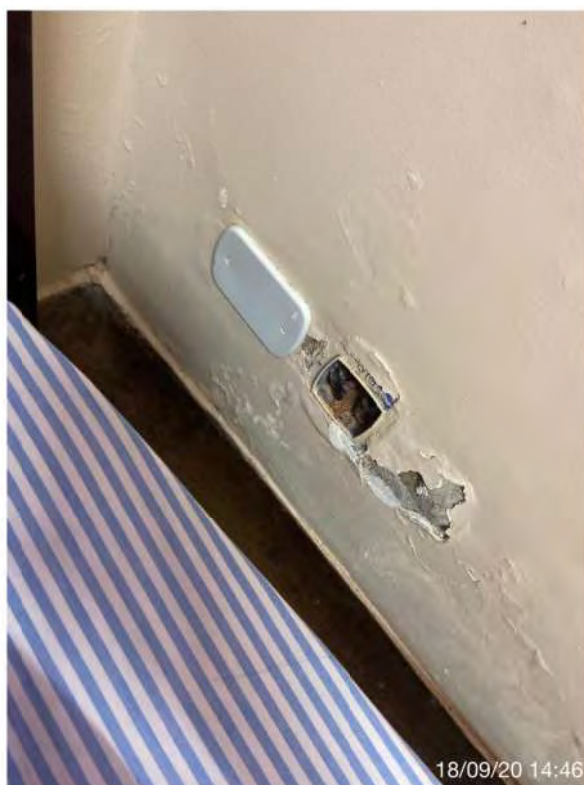
Instalações elétricas precárias
